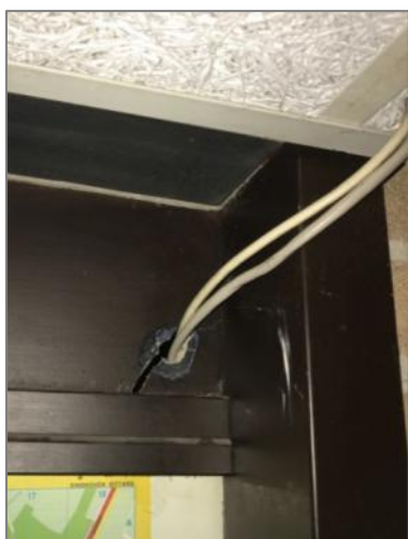
Punt 4: Doorbreken van de brandcompartmentering
