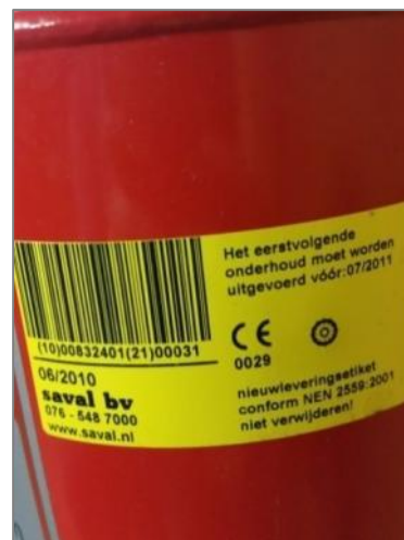
Punt 3: Niet of niet tijdig gekeurde blusmiddelen
