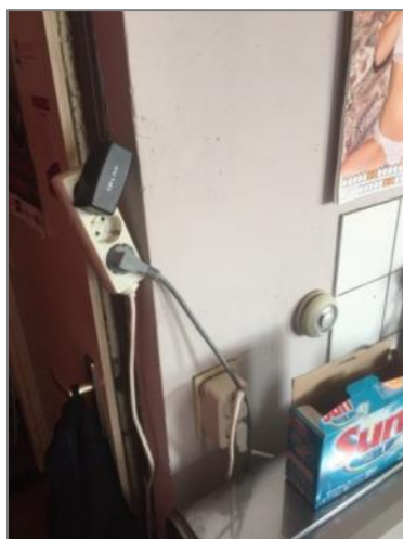
Punt 2: Overbelasting elektra, doorlussen open verdeelkasten
